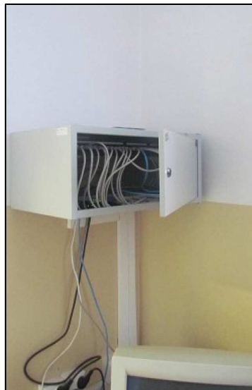
Rys. IV.10. Miejsce instalacji szafki RACK w pracowni informatycznej w szkole
