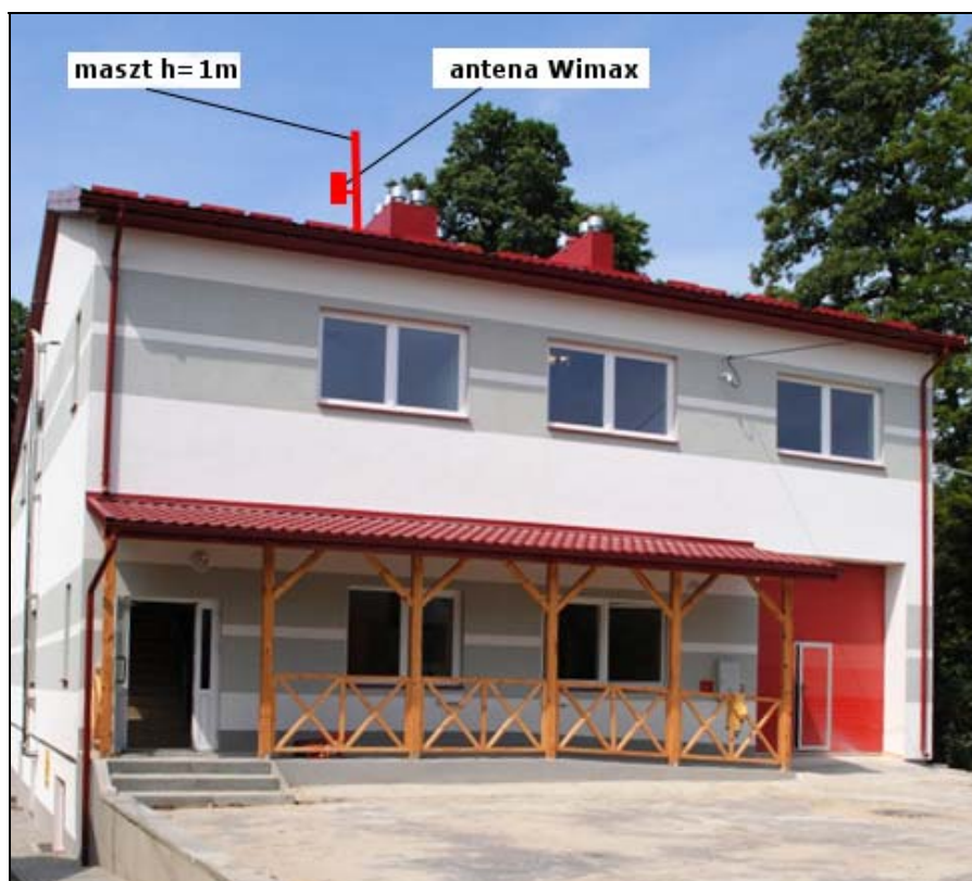
Rys. IV.48. Miejsce montażu masztu i anteny na dachu budynku
