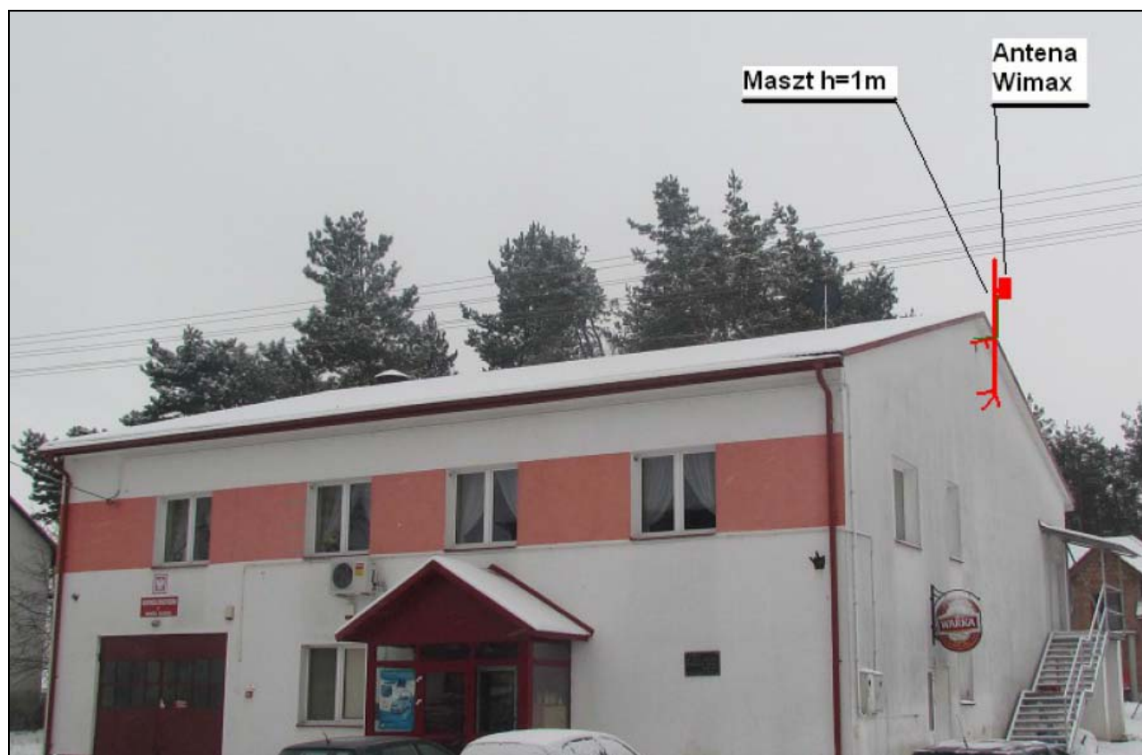
Rys. IV.45. Miejsce montażu masztu i anteny na dachu budynku
